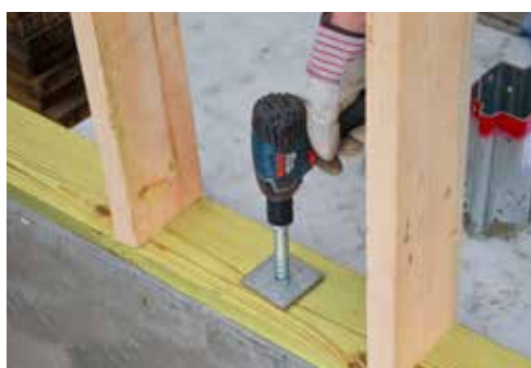
Fijación de vigas o durmiente bajo en las obras de estructuras de madera
